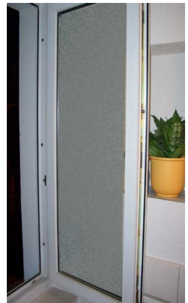
Komplett beschlagene Fensterscheibe am Anfang des Lüftungsvorganges.
